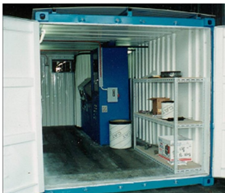
Figura 6.5: Contenedor del servicio de limpieza de filtros de aire.
