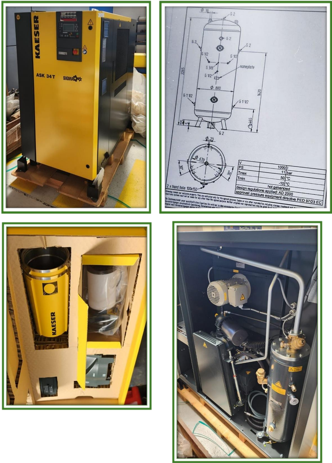
Ilustración 3-20. Compresor y equipos secundarios
