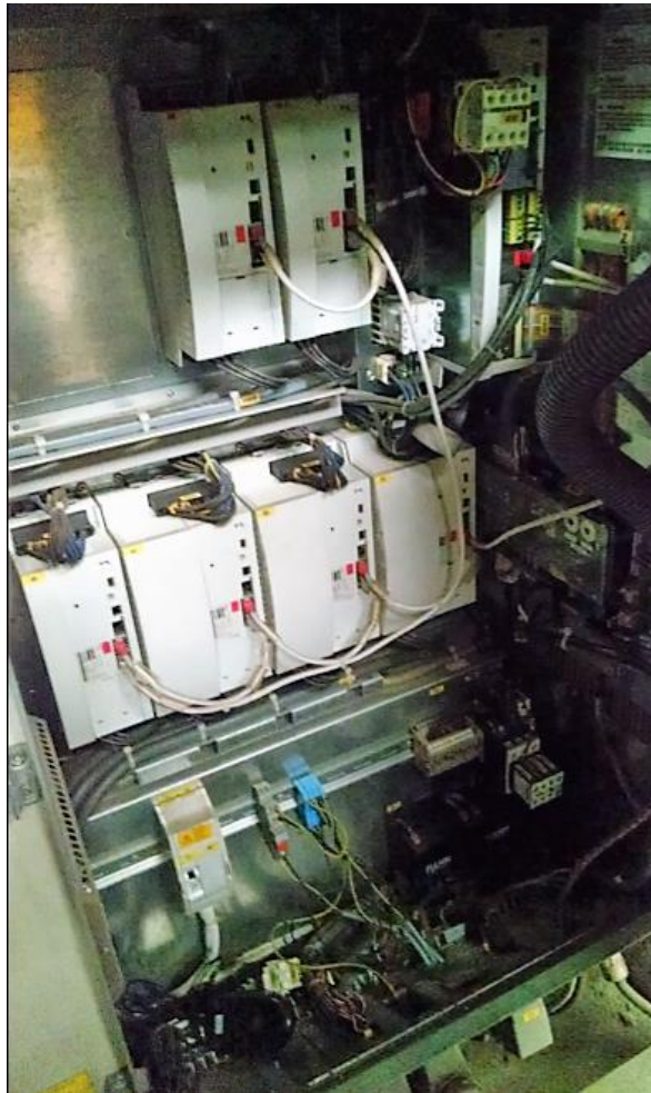
Figura 4.3 Gabinete controlador KRC2 con puerta abierta
