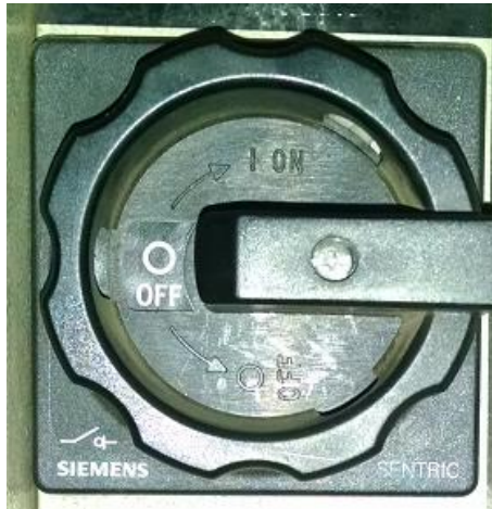
Figura 2.2 Interruptor en apagado
