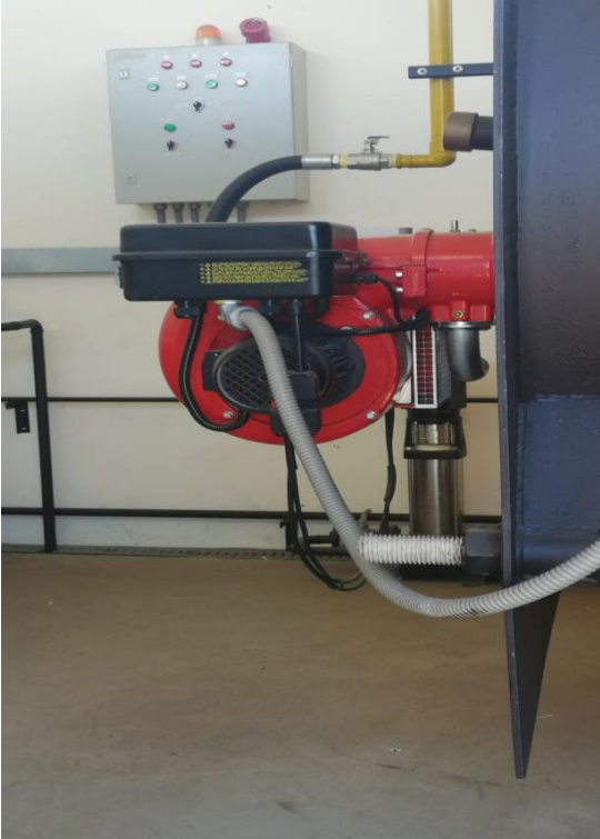
Imagen del fogón de la caldera
