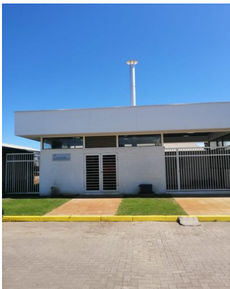
Imagen que muestra la chimenea de la caldera que sobre sale de su sala
