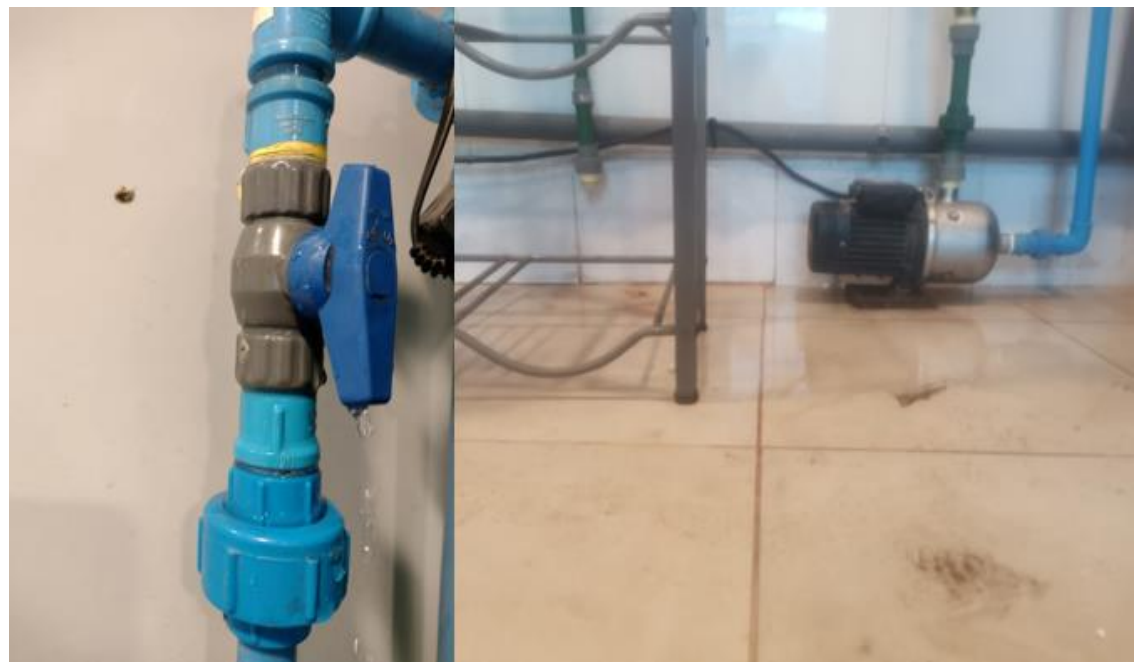
Fuente: fotografía personal de filtraciones.
