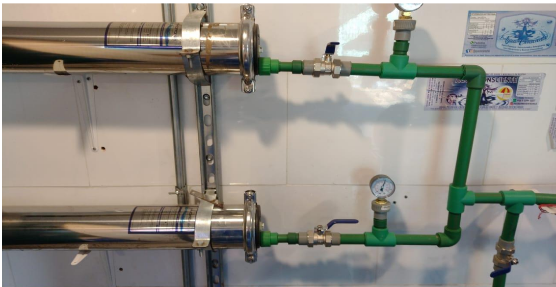
Fuente: fotografía personal a conexión de entrada a membranas de osmosis inversa.
