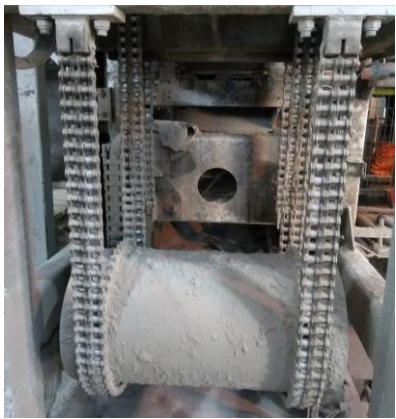
Figura 3-27 Contrapeso del elevador
