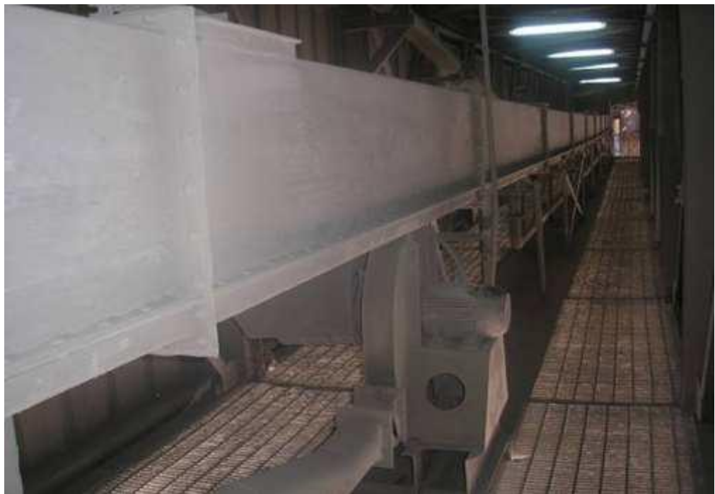
Figura 2-3 Canaletas de Transporte
