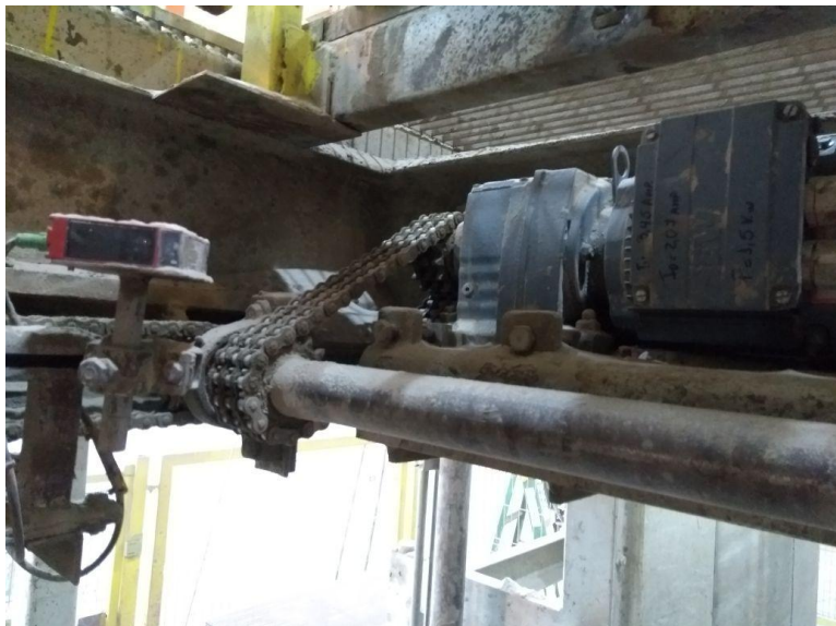
Figura 3-22 Transmisión de eje motriz de la mesa elevadora
