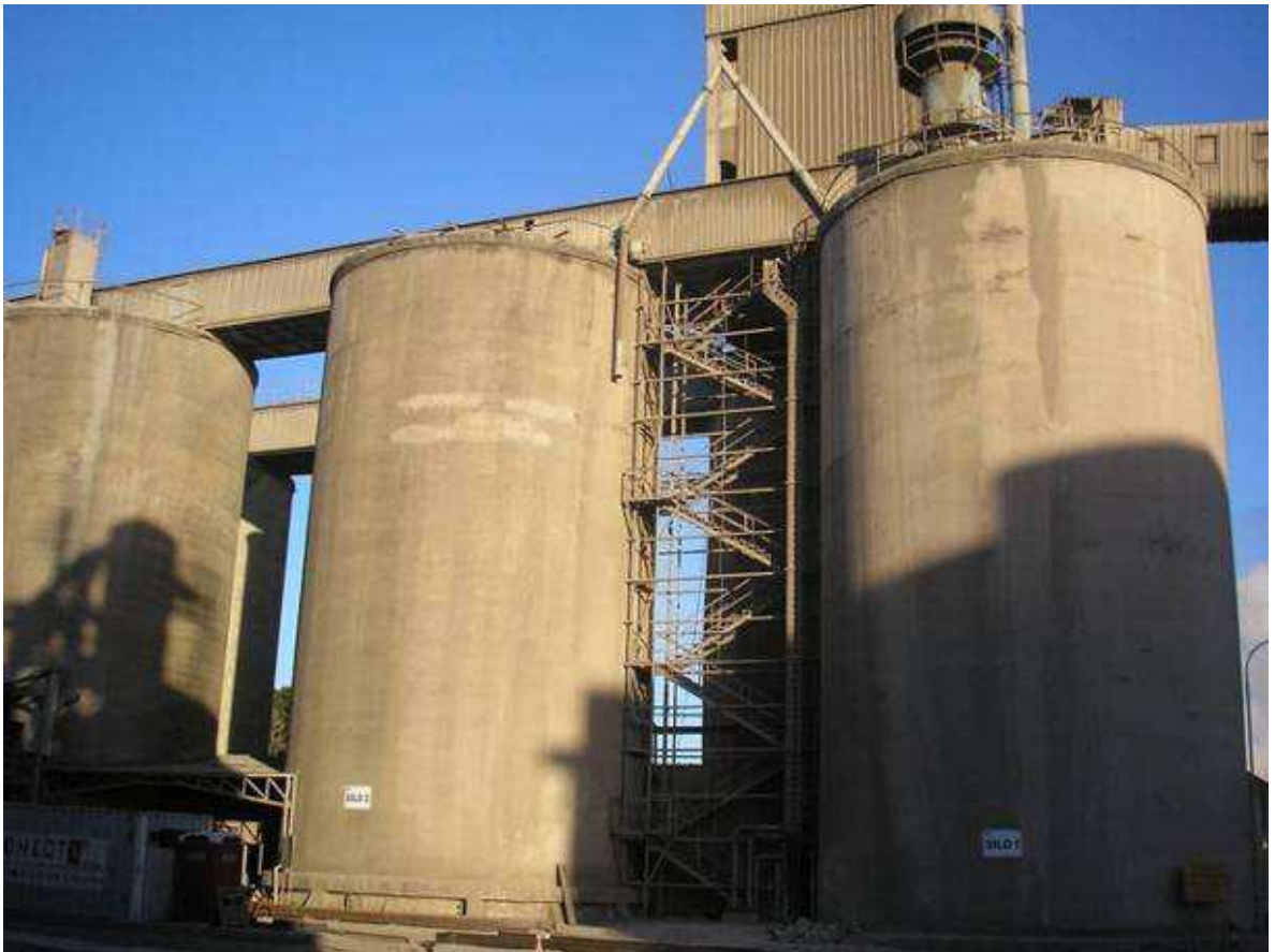
Figura 2-2 Silos de Almacenamiento
