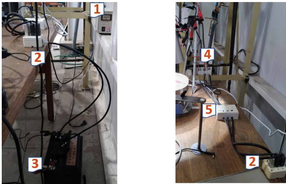
Imagen 5-3: Disposición del sistema eléctrico. (1) Cargador de batería, (2) conexión batería-toma de corriente, (3) batería de auto, (4) conexión lámpara-cable trifásico.
