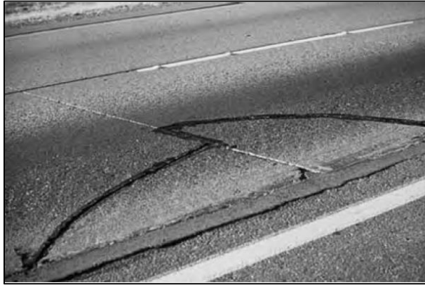
Figura 2-2: Pavimentos de Hormigón - Agrietamiento de Esquina (Delatte, 2007).
