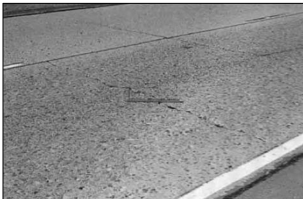
Figura 2-4: Pavimentos de Hormigón-Agrietamiento Transversales (Delatte, 2007).
