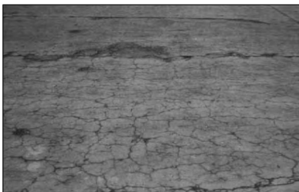
Figura 2-6: Pavimentos de Hormigón - Agrietamiento por Retracción (Delatte, 2007).
