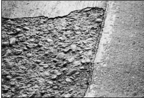
Figura 2-7: Pavimentos de Hormigón-Escalamiento (Delatte, 2007).
