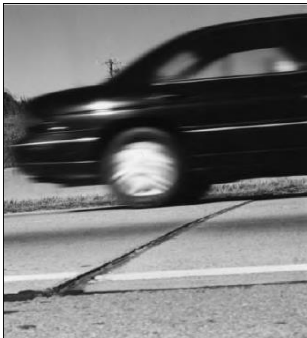
Figura 2-8: Pavimentos de Hormigón-Escalonamiento de Juntas Transversales (Delatte, 2007).
