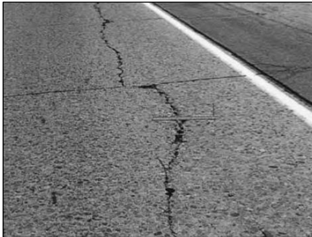
Figura 2-3: Pavimentos de Hormigón – Agrietamiento Longitudinales (Delatte, 2007).
