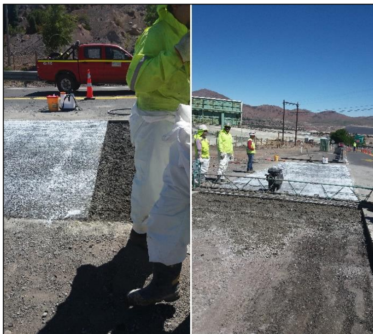
Figura 5-16: Inconvenientes Pavimentación km 41 - Junta Fría por Retraso de Camión Mixer.
