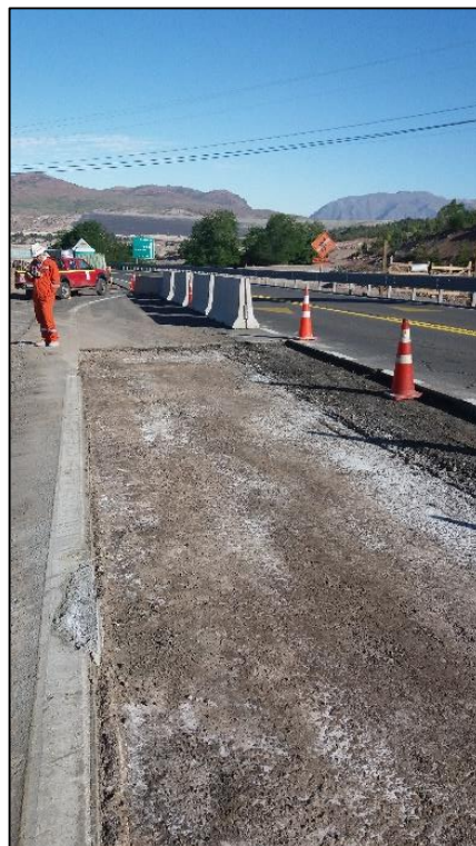
Figura 5-5: Inconvenientes Pavimentación con Losas Cortas – Berma Asfáltica Antigua.
