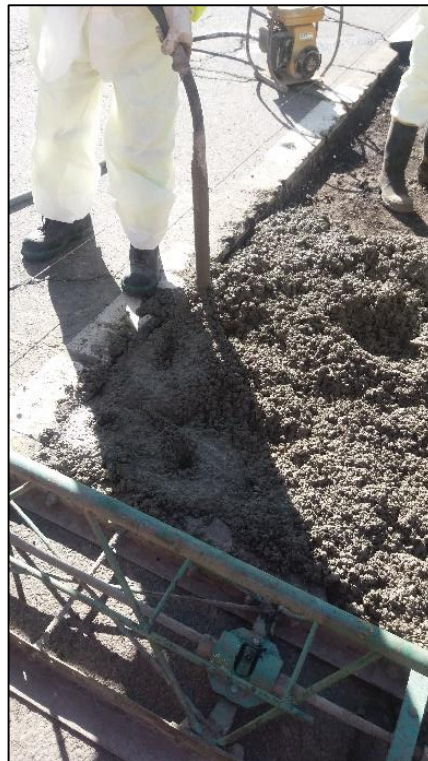
Figura 5-17: Inconvenientes Pavimentación km 41 – Problemas de Vibrado del Hormigón.
