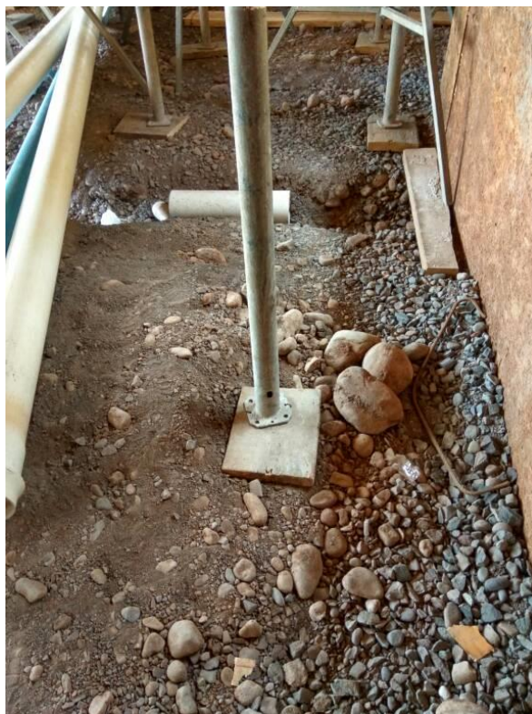
Figura 6-22. Ausencia de trípode en alzaprima según plano de montaje. Fuente: Fotografía propia.
