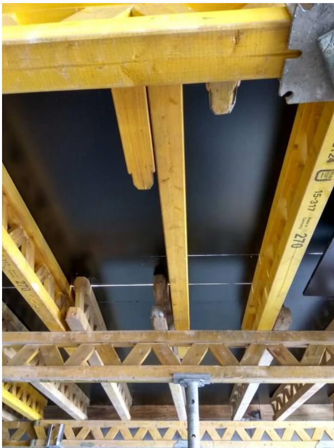
Figura 6-23. Ausencia de viga secundaria según plano de montaje. Fuente: Fotografía propia.
