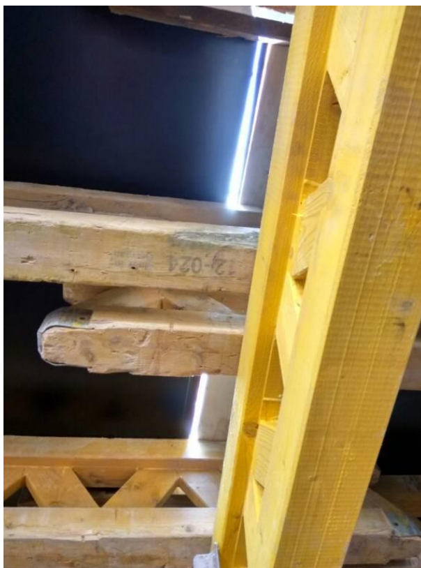
Figura 6-24. Incumplimiento de estanqueidad de placas con espacio excesivo. Fuente: Fotografía propia.
