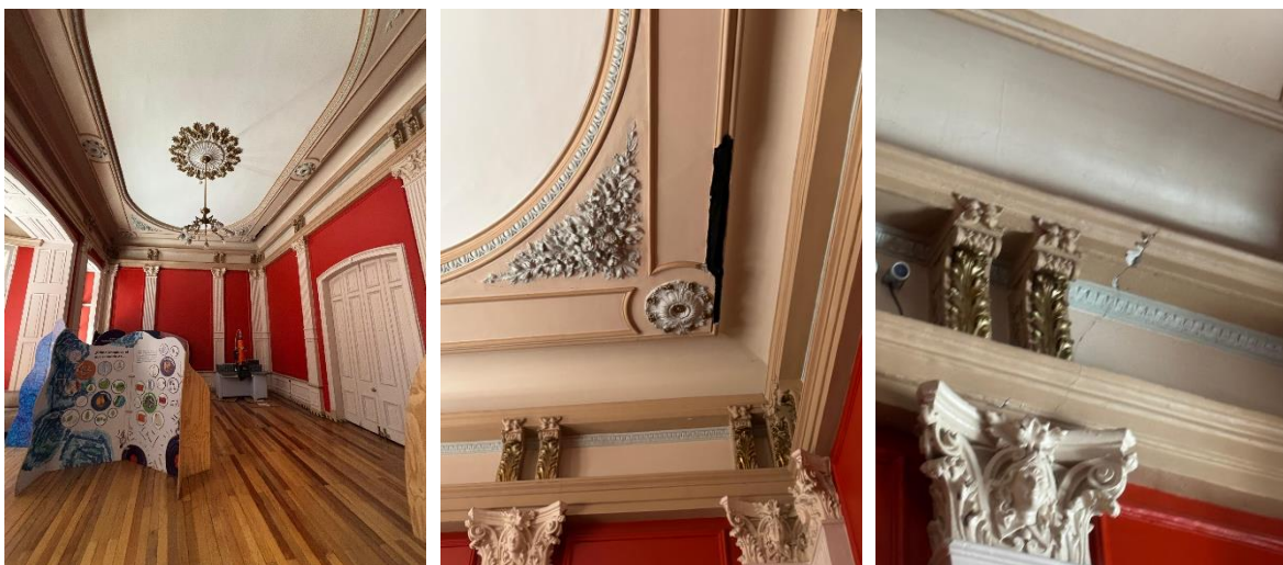
Figura 19. Habitación de lectura y fisuras.
