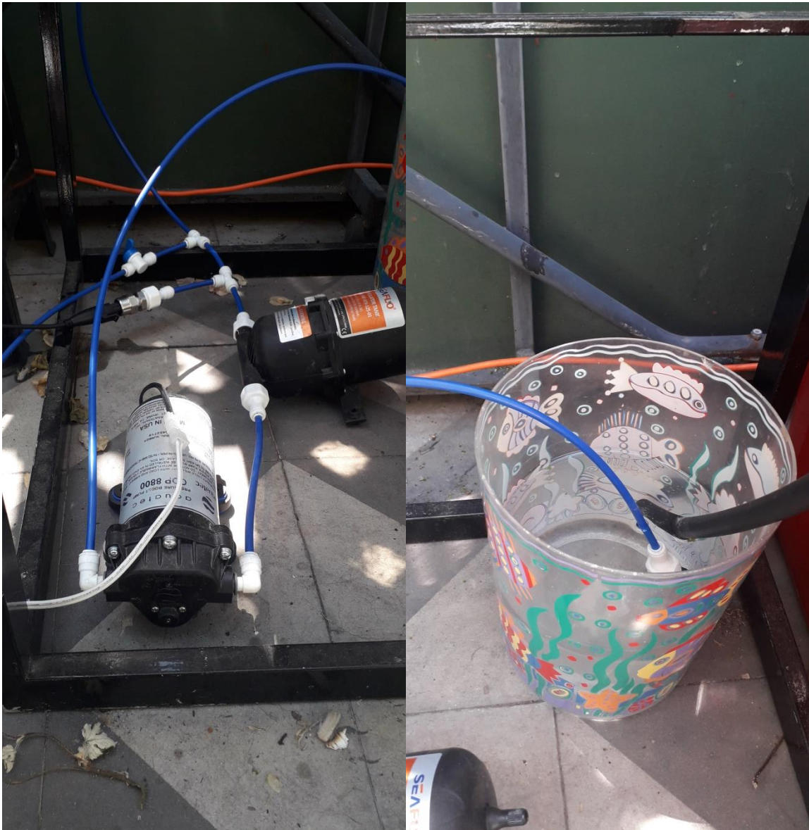
Figura 50. Bomba, tanque acumulador de presión, estanque de agua y transductor de presión. En el estanque de agua se ve la manguera azul que va hacia la bomba, la cual tiene un filtro en ella, y una manguera negra que es el retorno que viene desde la cámara de cultivo.
