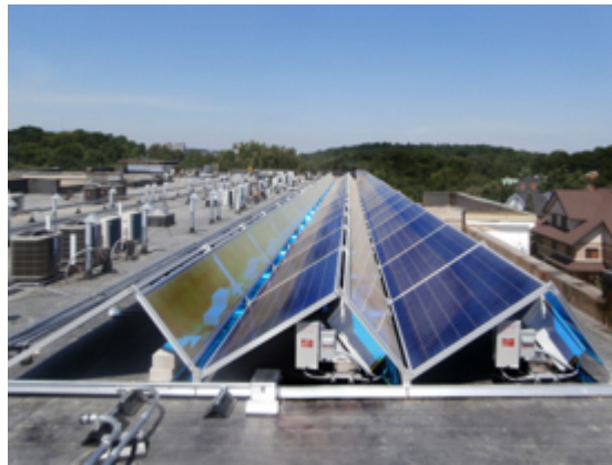
Figura 1.10: Instalación TenkSolar- Frederick MD Fuente: Tenk Energy
