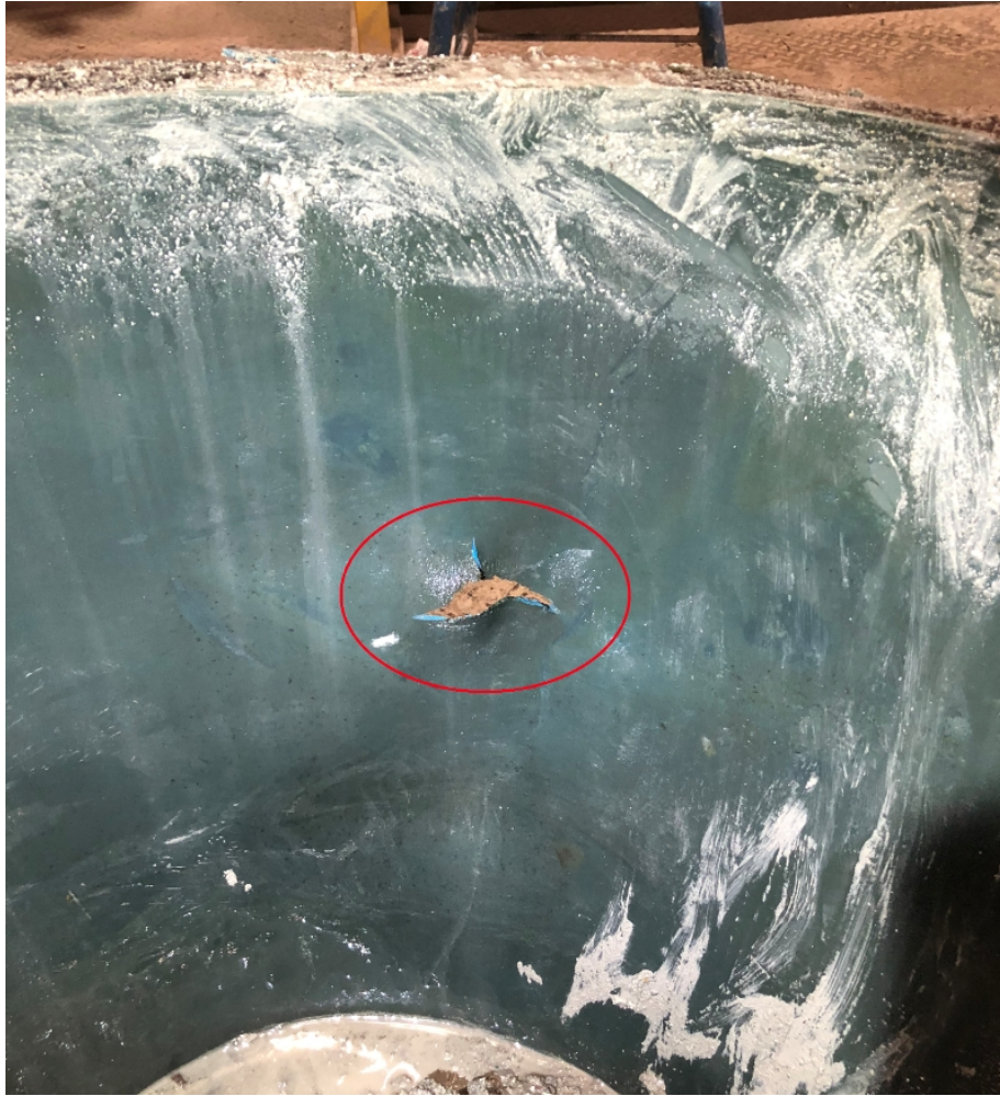
Figura 2.19: Rotura de revestimiento en cono superior, lo que provoca una nula clasificación.
