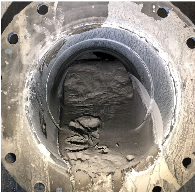
Figura 2.17: Ciclón en condición de embancamiento.
