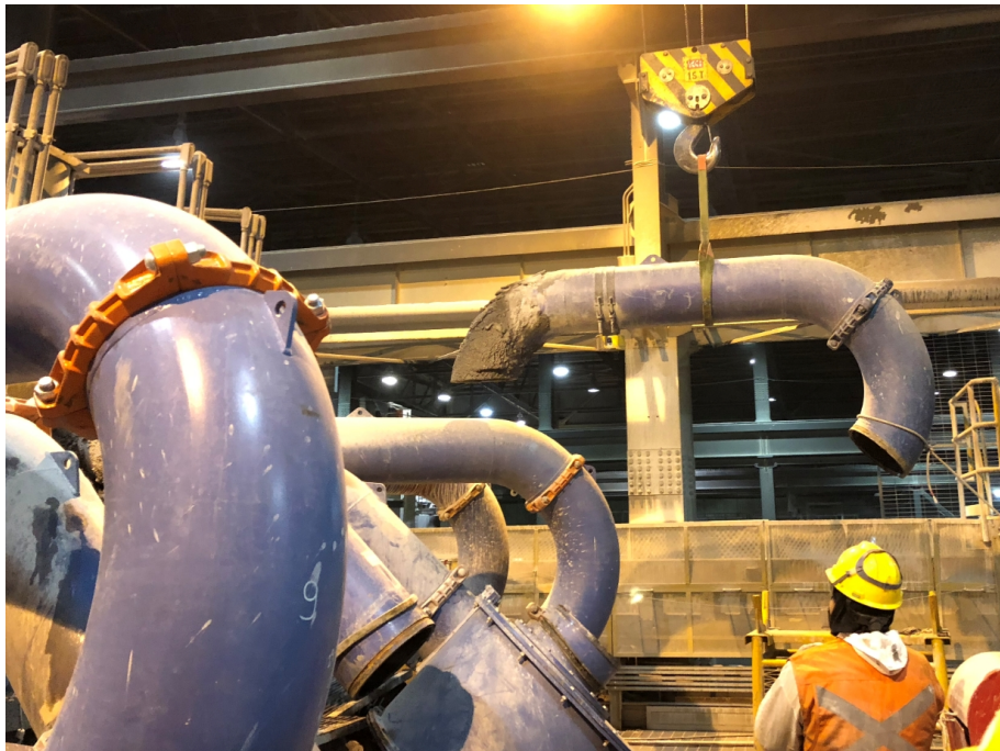
Figura 2.18: Personal de empresa colaboradora en maniobras de izaje para el cambio de un ciclón.
