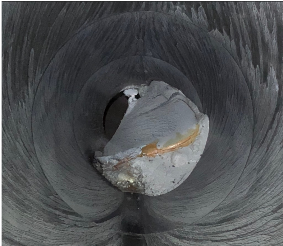
Figura 2.15: Obstrucción de apex por placa metálica externa.
