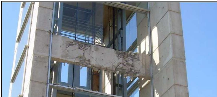
Figura 1 Fotografía de la estructura del ascensor aeropuerto dañada en el terremoto 2010. (Schnaidt 2010, fotografía proporcionada al profesor guía).
