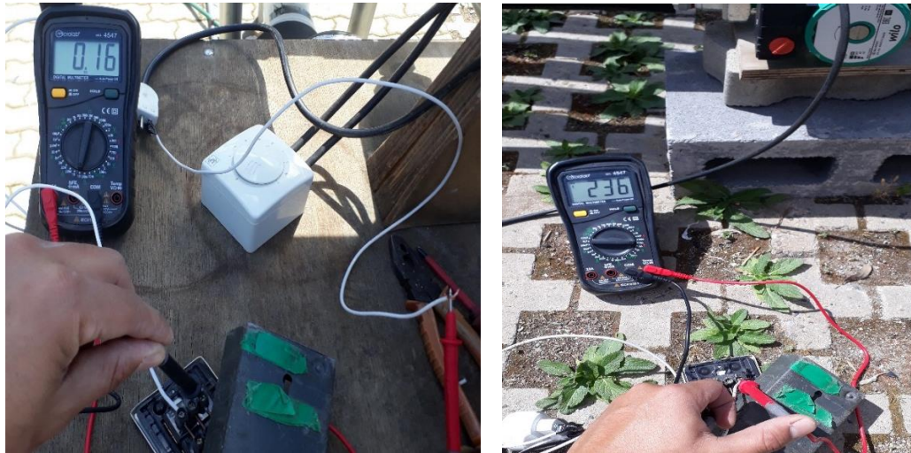
Figura 3-12 Medición de corriente y voltaje de las bombas y ventiladores
