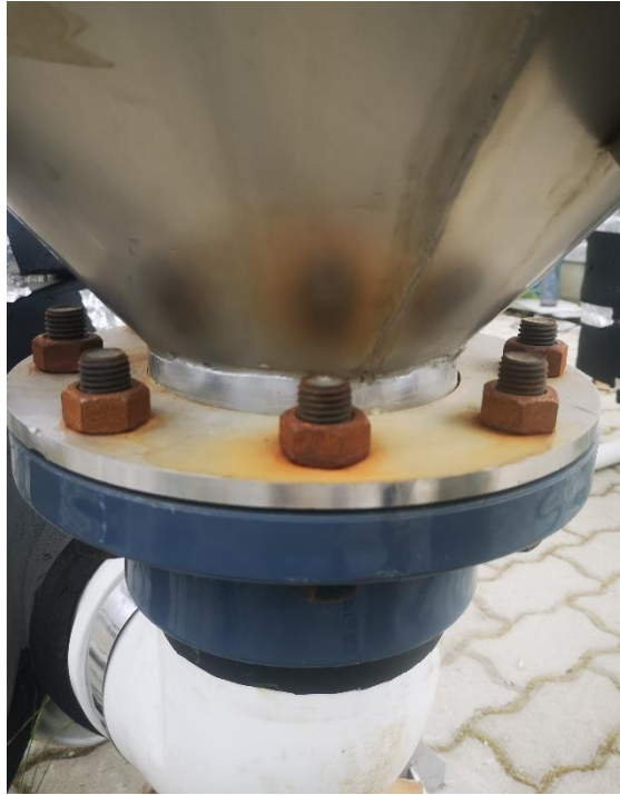
Figura 3-4 Arreglo fuga por la parte inferior del humidificador.
