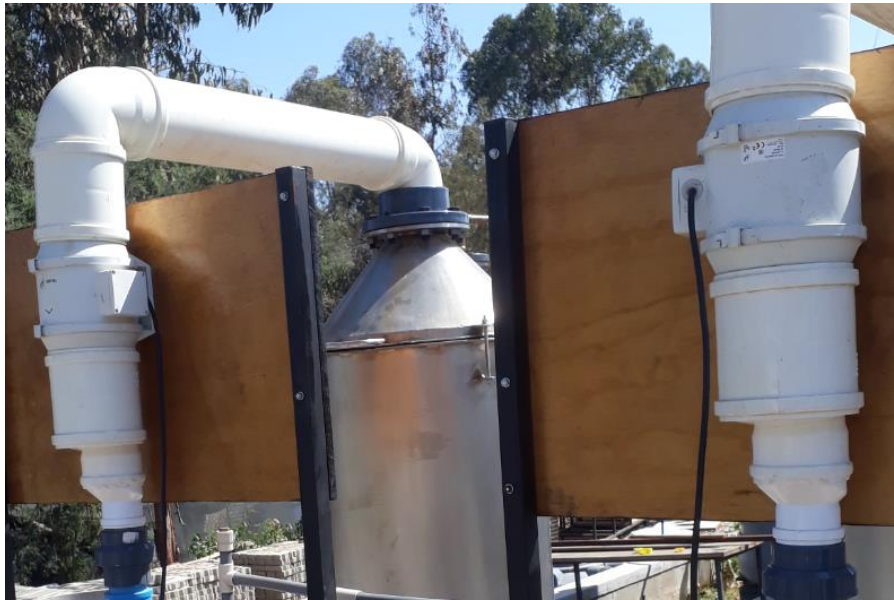
Figura 3-7 Piping donde van sujetos los ventiladores de ambas etapas
