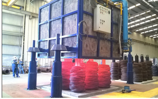
Figura 2.2: Horno para recocido de alambre de acero
