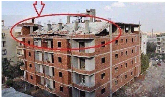
Ilustración 4 - Falla por punzonamiento mostrada por @Mundo_Hormigon (9)
