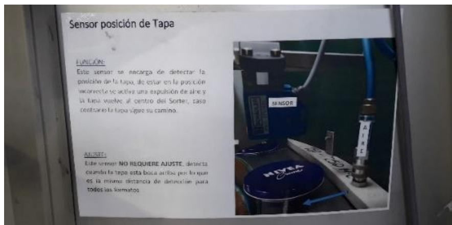
Figura 6-3: Instructivo instalado en el equipo
