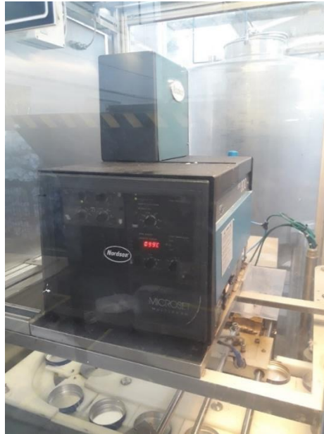
Figura 2-10: Equipo encargado de calefaccionar y almacenar la cera
