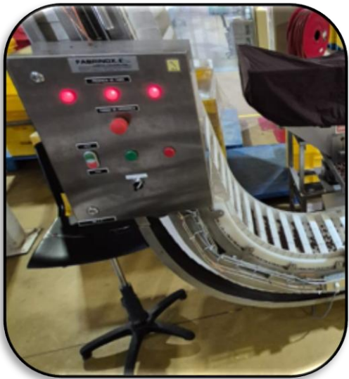
Figura II-8: Tablero Eléctrico de Cinta Modular
