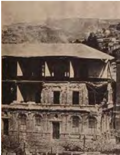
Fig. 25 Caída de los muros de fachada del segundo y tercer piso del Colegio de los S.S.C.C |Fuente: Revista Sucesos, 1906
