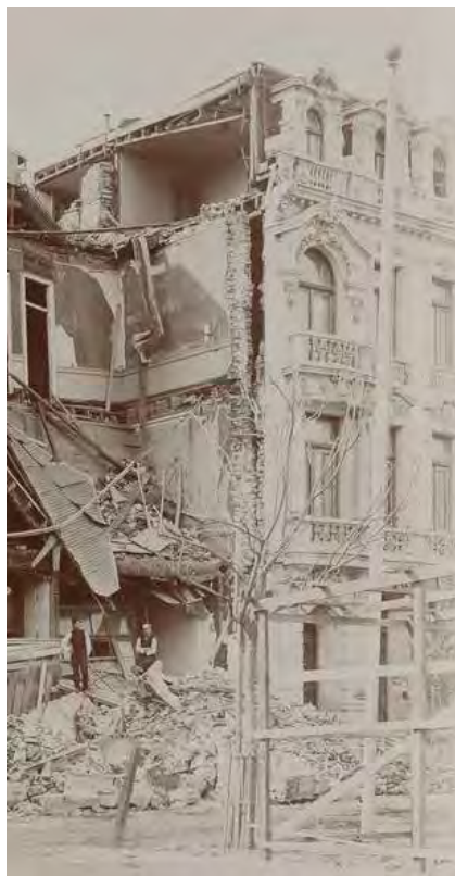
Fig. 21 Desprendimiento del muro de fachada, edificio en Avenida Brasil |Fuente: Gallica, Biblioteca Nacional de Francia.
