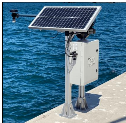
Figura 1. Estación mareográfica equipada con sensores GNSS para monitoreo del nivel del mar en tiempo real. Fuente: Deep Insight.
