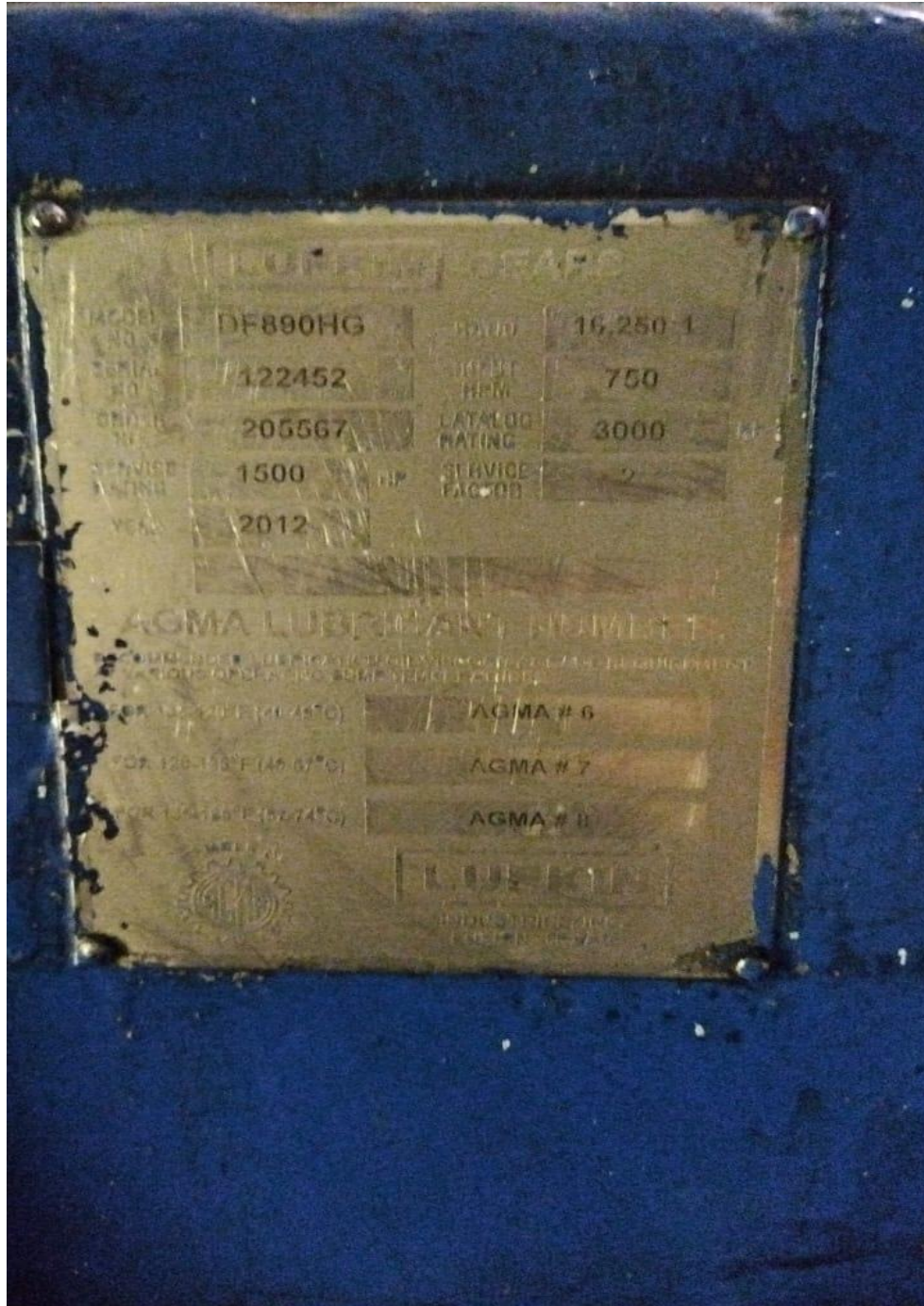
Figura 17. Placa caja reductora principal Mixer 5.
