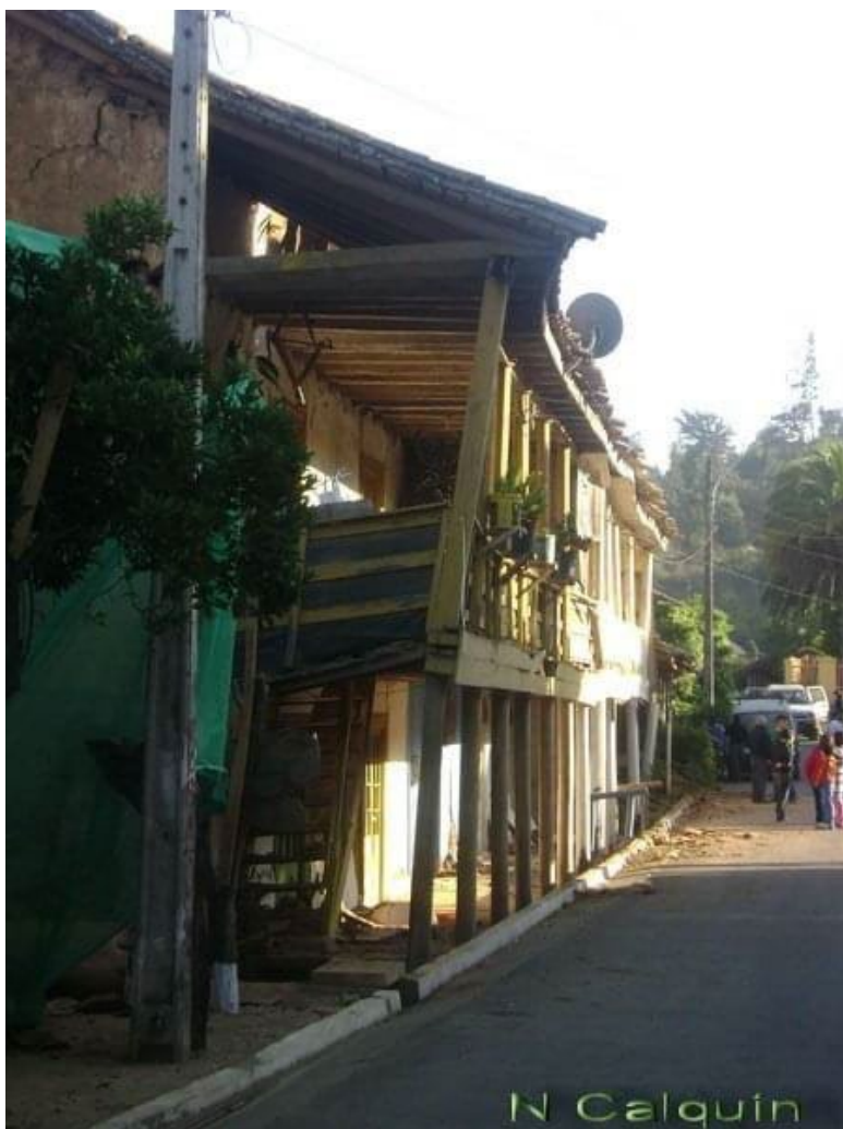
B.5 Imagen post-terremoto 2010, antiguo edificio municipal
