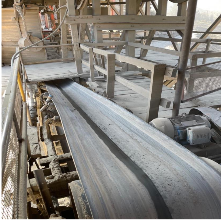
Figura 3-10: Cinta S-4 en condiciones para puesta en servicio
