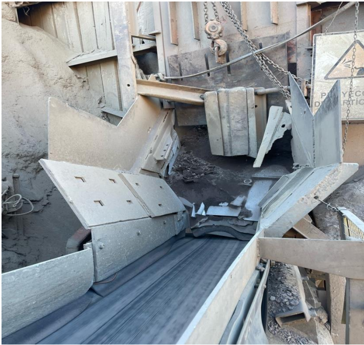
Figura 3-11: Tolva Blake y cinta auxiliar 2 en condiciones para puesta de servicio.
