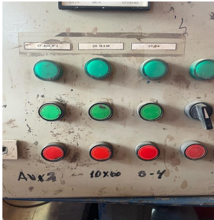
Figura 3-12: Botonera ubicada en la caseta de operación
