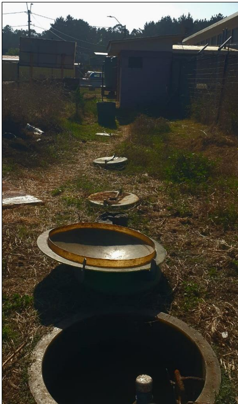
Figura Anexo 1. Vista superficial del sistema de tratamiento instalado en ‘Los Almendros’. Obtención propia a partir de la campaña de muestreo en terreno. Mayo 2025.
