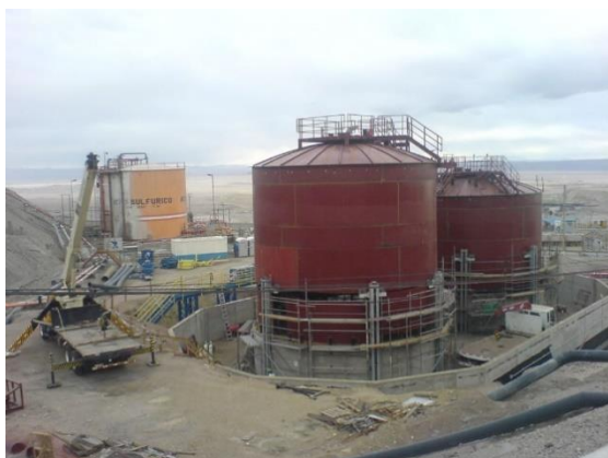
Estanque techo cónico.
