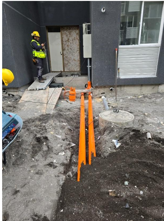
Ilustración 1-4 Canalización de caja hacia cámara de distribución, Fuente: Elaboración propia.
