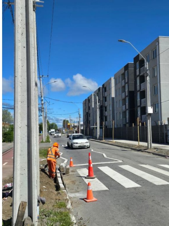
Ilustración 1-5 Alumbrado público, Fuente: Elaboración propia.
