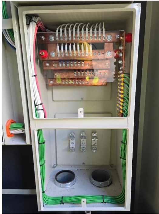
Ilustración 1-3 Caja de barras y NH, Fuente: Elaboración propia.
