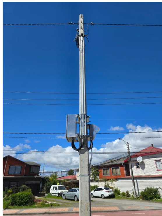
Ilustración 1-6 Empalme con tablero de control y canalización, Fuente: Elaboración propia.
