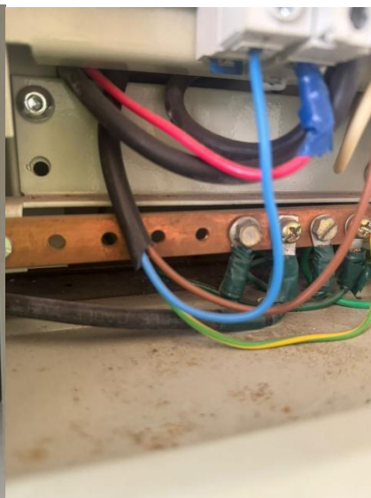
Fig.1.3 Detalle interior de tablero evidenciando ausencia de protección de Diferenciales.
