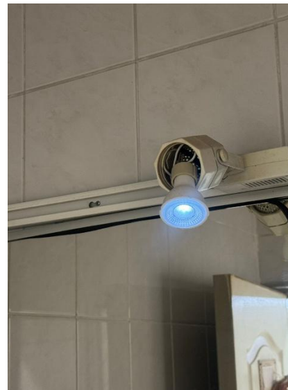
Fig.1.4 Luminaria sin protección y conductores expuestos en área húmeda.
