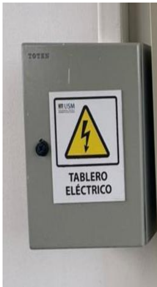
Fig.1.2 Tablero Eléctrico Edificio Daniel Alkalay.
