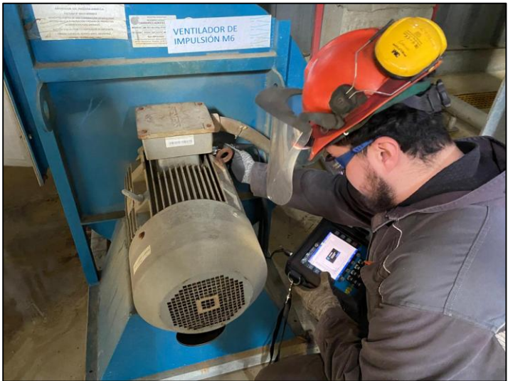
Figura 1. 2: Análisis de vibraciones en equipo ventilador.
