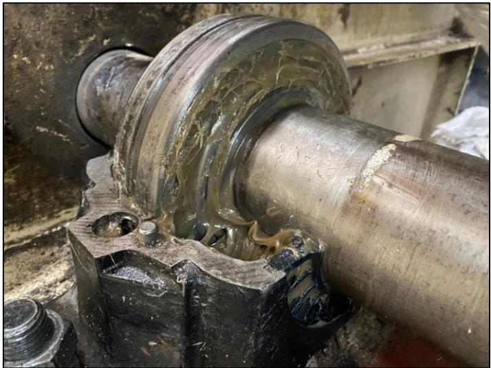
Figura 1. 1: Cambio de grasa en descansos de conjunto ventilador.
