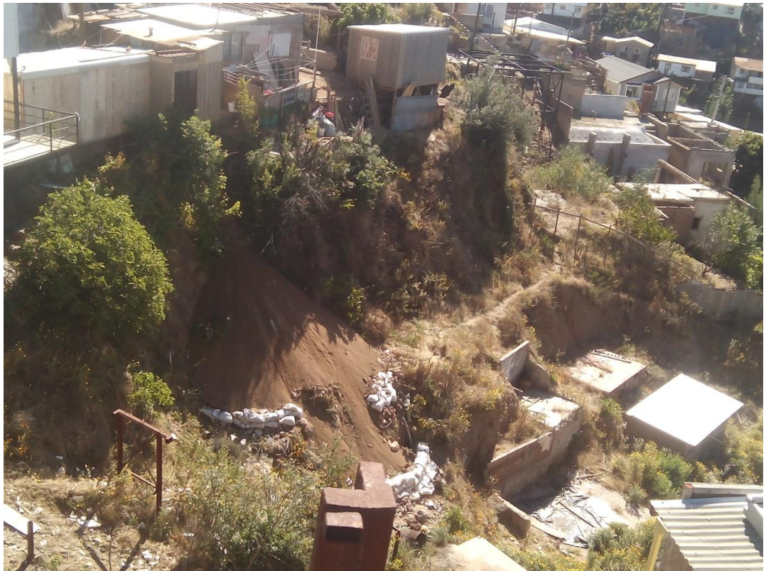
Figura 2-29. Vista general de escombros en la quebrada, TD N°88-2016
