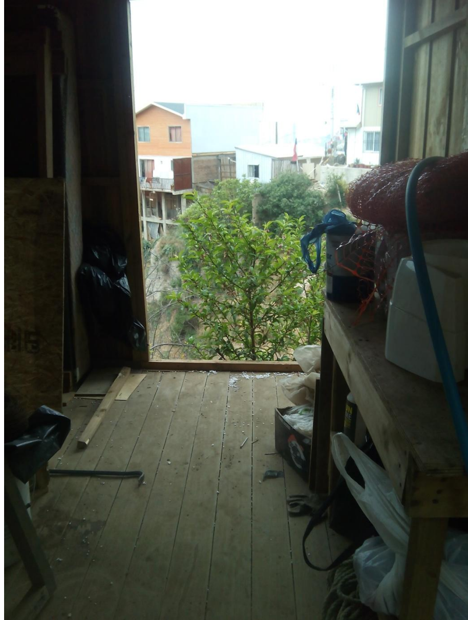
Figura 2-27. Zona por donde se sacaron escombros hacia la quebrada, TD N°88-2016
