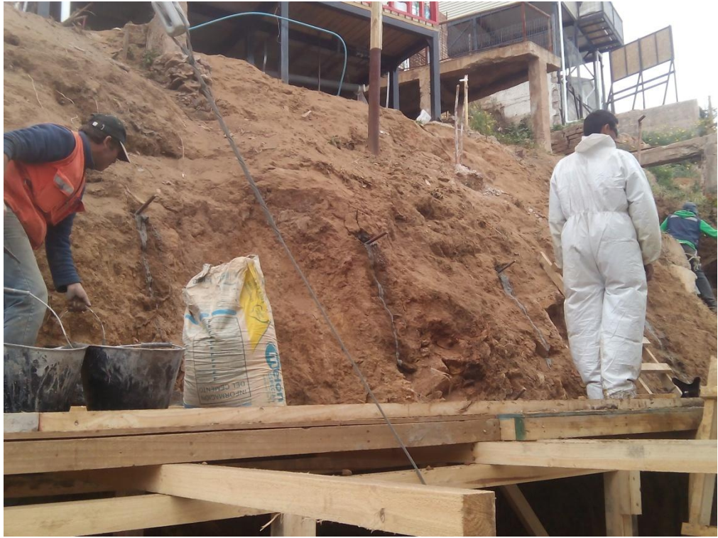
Figura 2-17. Perforación e instalación de pernos A37-24ES de Ø22 mm shotcrete, TD N°88-2016
