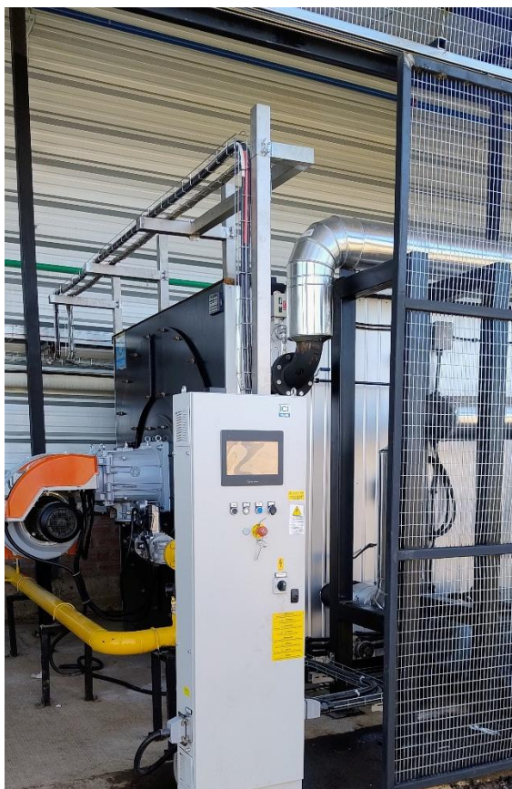
Figura 90: Panel de Control - Zona de Caldera
