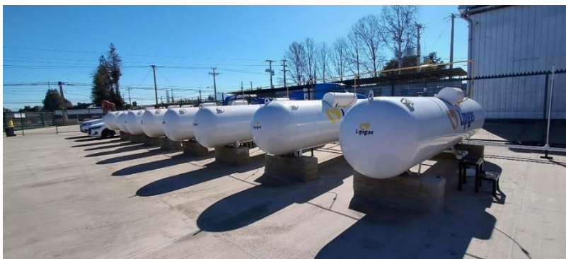
Figura 82: Central de almacenamiento de GLP
