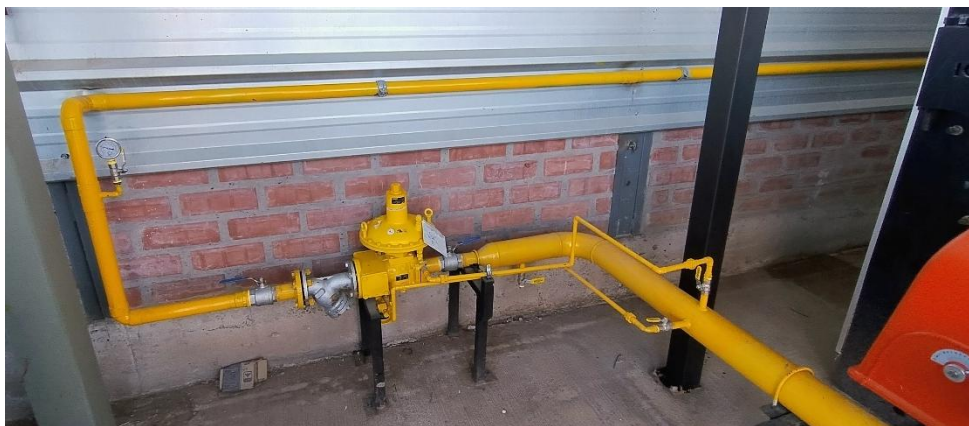
Figura 88: Regulación Segunda Etapa, Caldera
