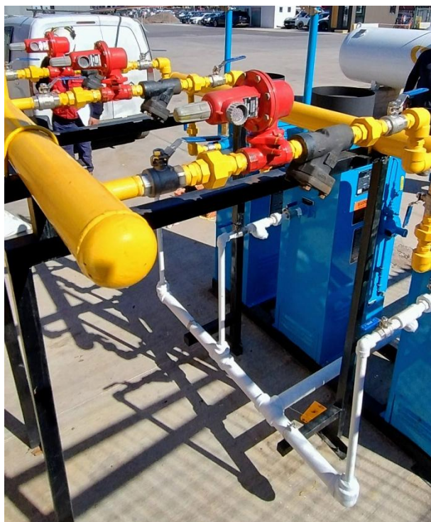
Figura 85: Regulación de Primera Etapa Vaporizadores
