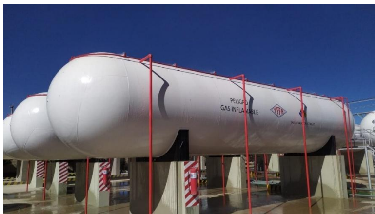
Figura 6: Estanque tipo aéreo, https://abi.bo/images/Noticias/Economia/sep-22/TANQUE_GLP.jpg
