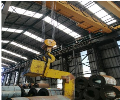
Imagen 4: Puente grúa. Fuente: CINTAC S.A.
