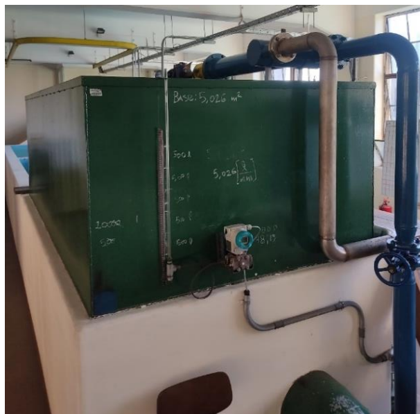
Figura N°20: Estanque receptor con tubo piezométrico graduado y sensor de presión hidrostático.
