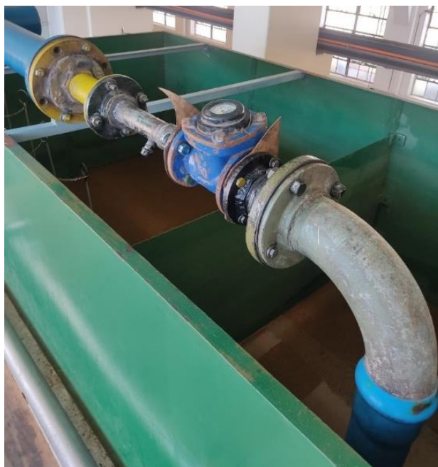
Figura N°22: Bridas con medidor montado.
