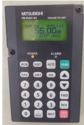
Figura N°19: Panel de control del variador de frecuencia.
