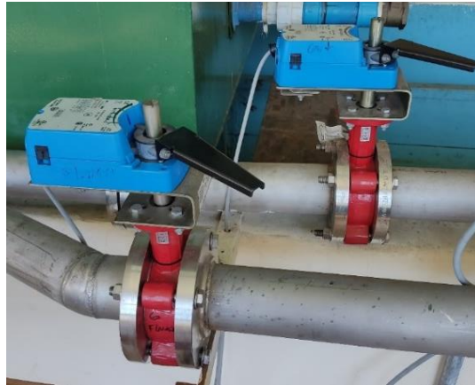
Figura N°23: Válvulas equipadas en el banco de pruebas.
