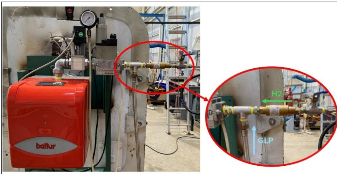
Ilustración 10. Conexión Bypass Flujos GLP - H2.
