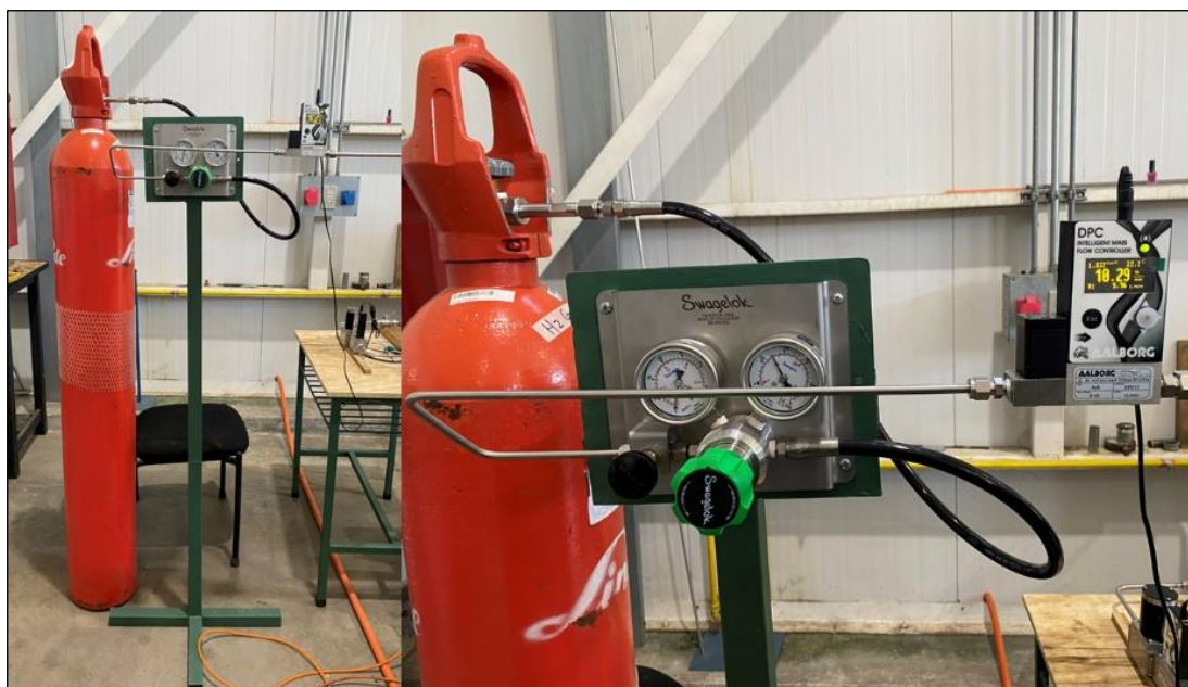
Ilustración 8. Bastidor - Panel de Regulación Hidrógeno.
