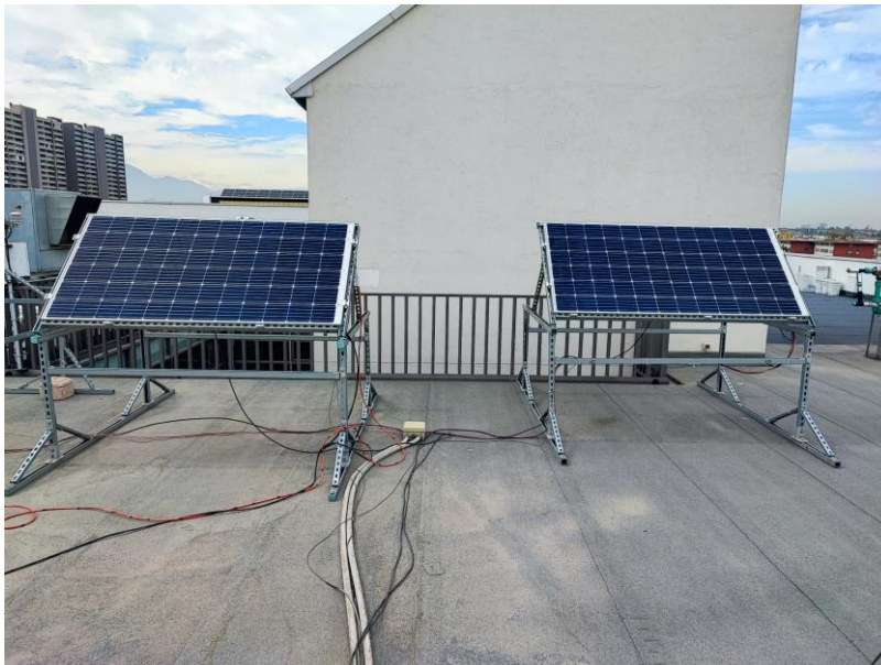
Figura 17: Módulos bifaciales. De izquierda a derecha se muestran los módulos B_2 y B_1 respectivamente instalados en el Laboratorio Outdoor. Fuente: Elaboración propia.
