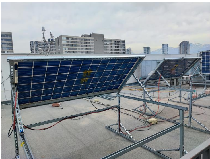
Figura 18: Parte posterior de módulos bifaciales. De izquierda a derecha se muestra el módulo B_1 y B_2 respectivamente. Se muestran las conexiones de corriente y sensores de temperatura hacia el datalogger. Fuente: Elaboración propia.
