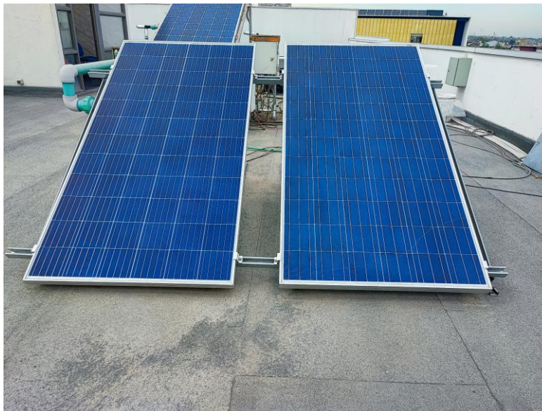
Figura 15: Módulos monofaciales. De izquierda a derecha se muestran los módulos M_2 y M_1 respectivamente instalados en el Laboratorio Outdoor. Fuente: Elaboración propia.
