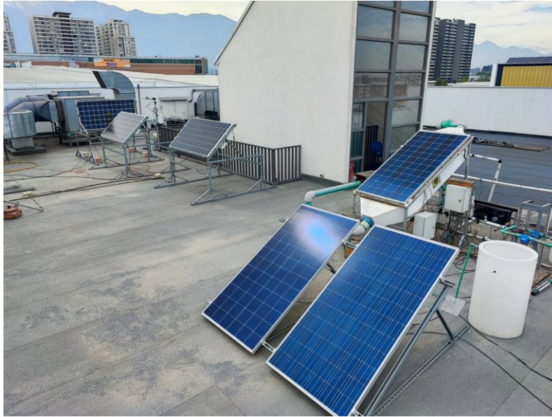
Figura 14: Módulos en evaluación instalados en el Laboratorio Outdoor de la universidad donde además se aprecian módulos y sistemas solares correspondientes a otros estudios en desarrollo. Fuente: Elaboración propia.
