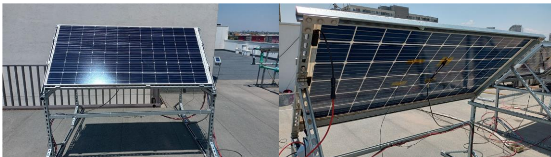
Figura 34: Módulo B_1 en medición con celda de referencia instalada en el POA (izquierda) y sensores de temperatura para medición de curva I-V y para adquisición continua de datos (derecha). Fuente: Elaboración propia.
