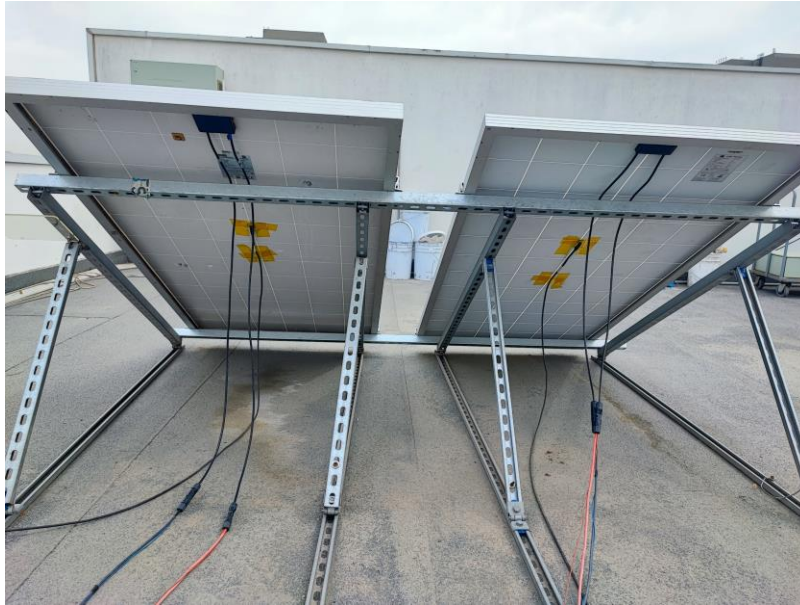
Figura 16: Parte posterior de módulos monofaciales. De izquierda a derecha se muestra el módulo M_1 y M_2 respectivamente. Se muestran las conexiones de corriente y sensores de temperatura hacia el datalogger. Fuente: Elaboración propia.
