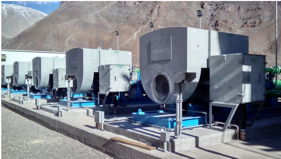
Ilustración 14: Bombas PP025 a PP029, EB2
