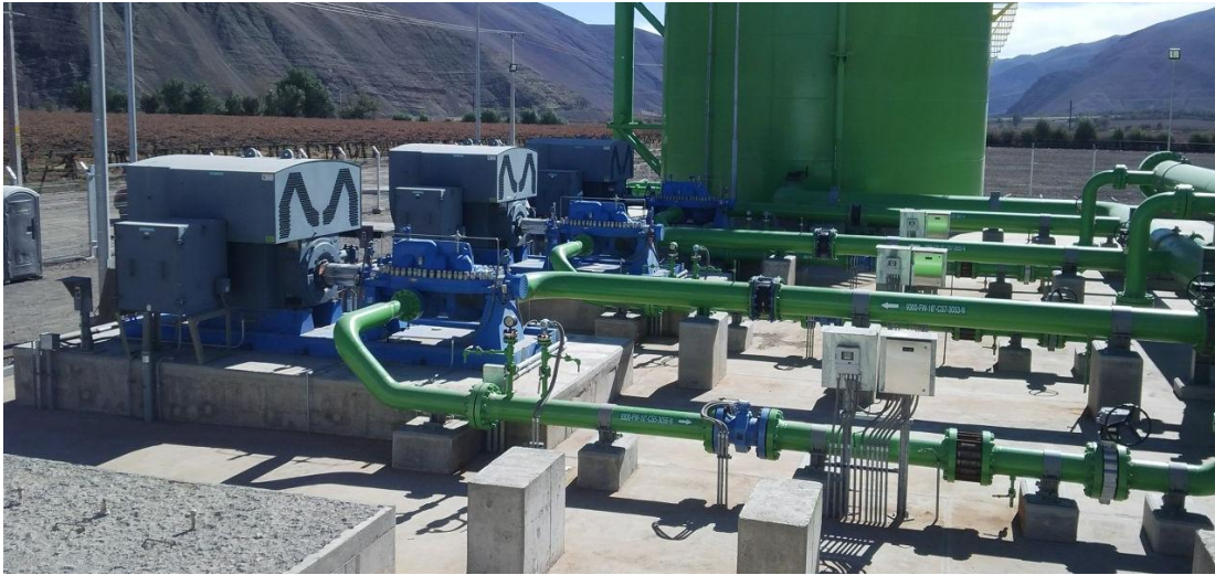
Ilustración 13: Configuración bombas PP020 a PP022, EB1
