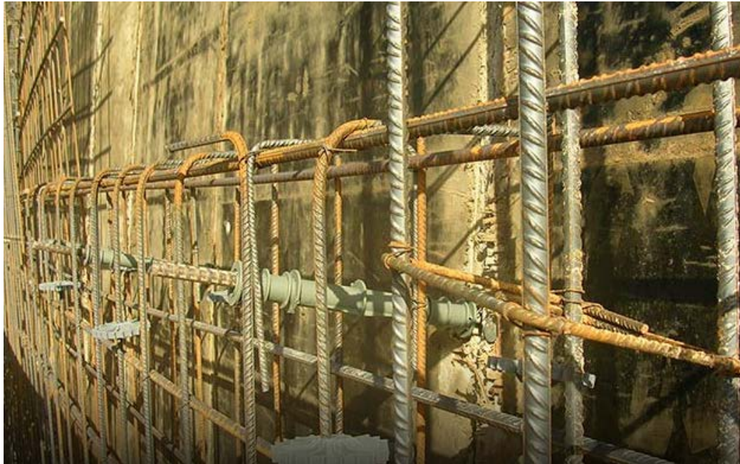
Figura 2-2 Deterioro en Moldes de Madera In Situ
