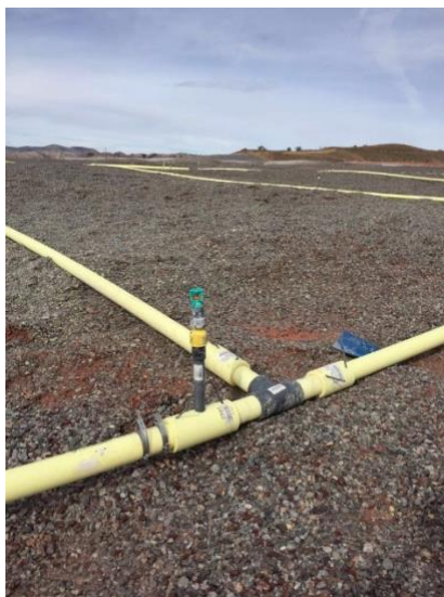
Figura 8: Válvula de control hidráulico instalado en el sistema de riego de una pila de lixiviación, que obtiene datos del flujo de solución lixivante. Fuente: BANFF S.A.
