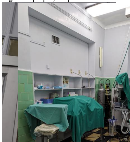
Figura 1.8. Rejilla de extracción de aire instalada sobre el acceso de pabellón quirúrgico.
