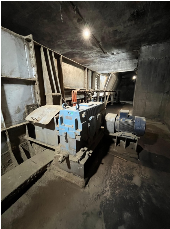
Figura 1- 7: Motor reclaimar con caja reductora
