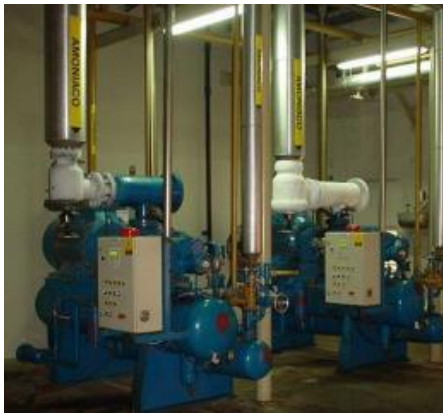
Ilustración 1(Compresores del sistema de refrigeración)
