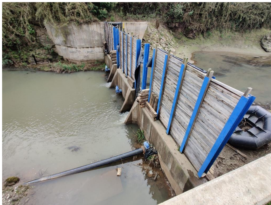
Figura 8: Captación abierta Iloca
