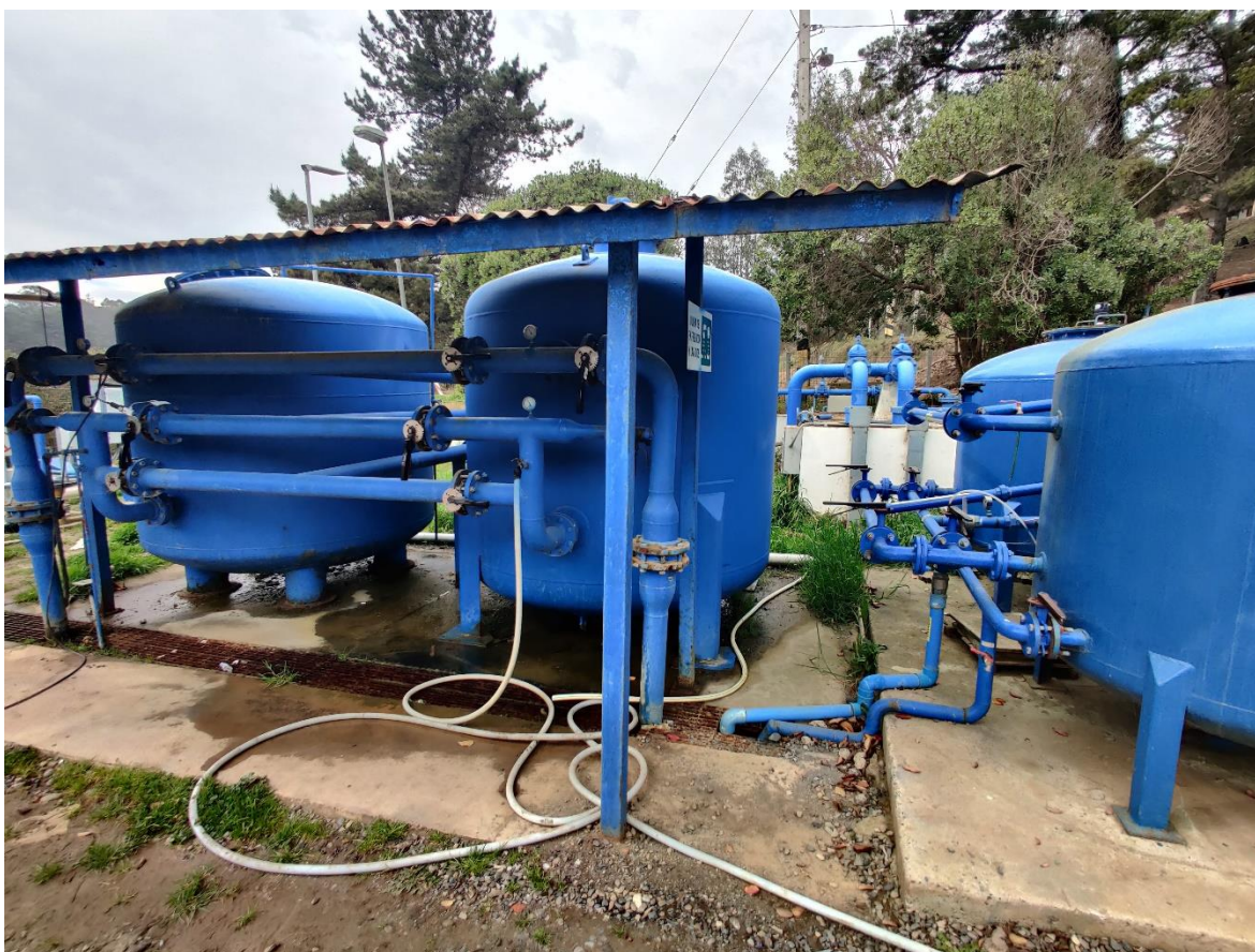
Figura 10: Planta de Tratamiento de Agua Potable Iloca
