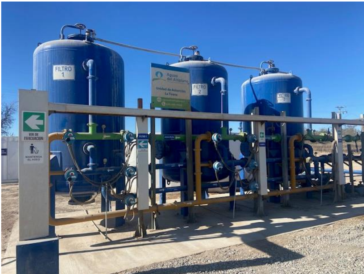
Figura 6: Planta de tratamiento de agua potable La Tirana
