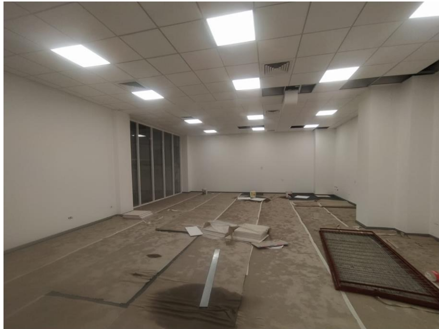
Figura 2 -7. Filtración de agua en una sala
