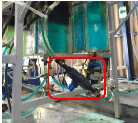
Figura 4.11. Vista posterior celda, recirculación de acuoso etapa de lavado.
