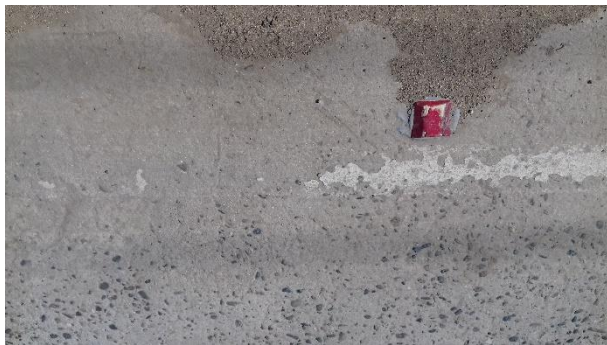
Figura 4-4 Decoloración línea en la vía
