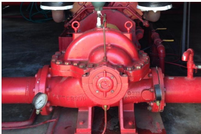
Figura 6 Imagen de bomba del SCI
