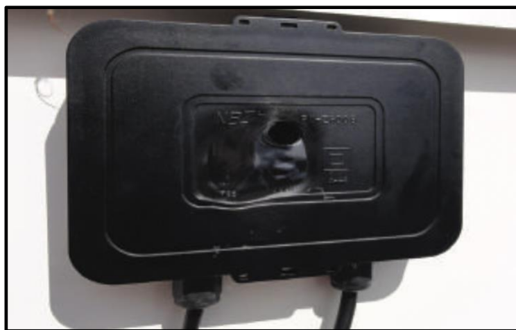
Figura 2-10 Soldadura de panel FV defectuosa.
