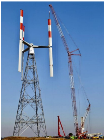
Figura 2.10: Turbina Sky A32 instalada
