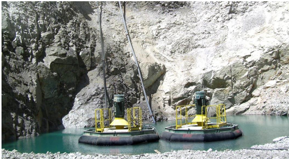
Figura 2.13: Bombas VS5 en operación (2) [9]
