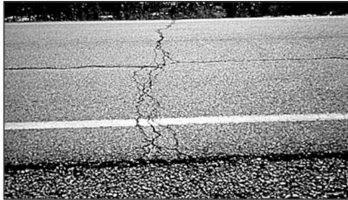
Figura 2- 2: Agrietamiento térmico en pavimentos asfálticos.
