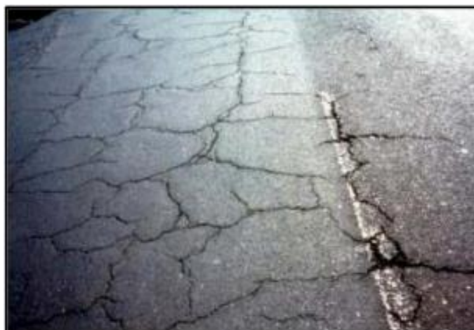
Figura 2- 3: Agrietamiento por fatiga en pavimentos asfálticos.
